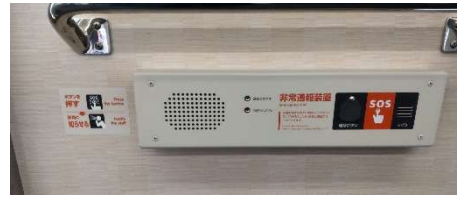
非常通報装置（車いすスペースに設置のもの）
