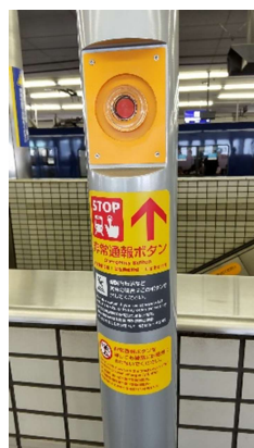
ホーム異常通報装置
