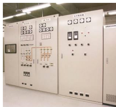
守口変電所内設備機器
