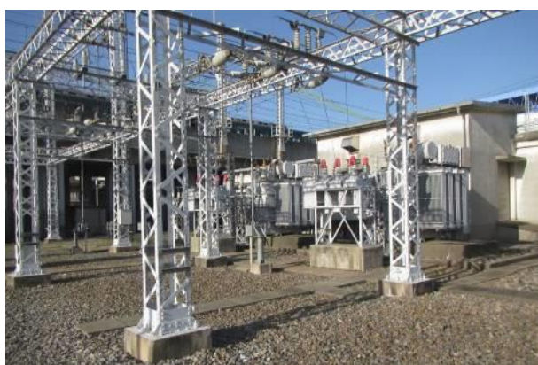
守口変電所の現況
